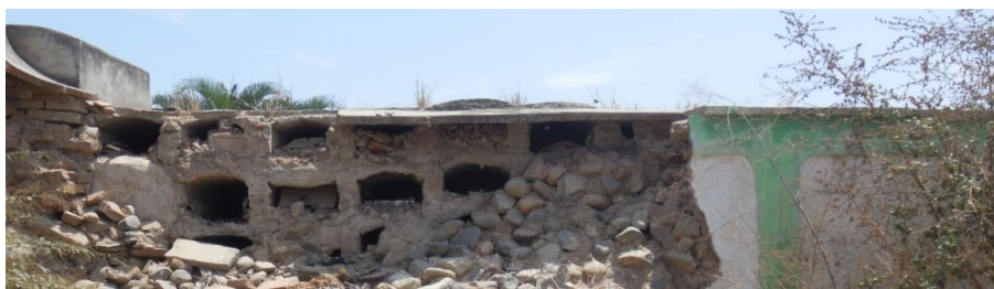
Vista de pabellón lateral del Cementerio El Carmen, destruido por el fenómeno del Niño Costero
