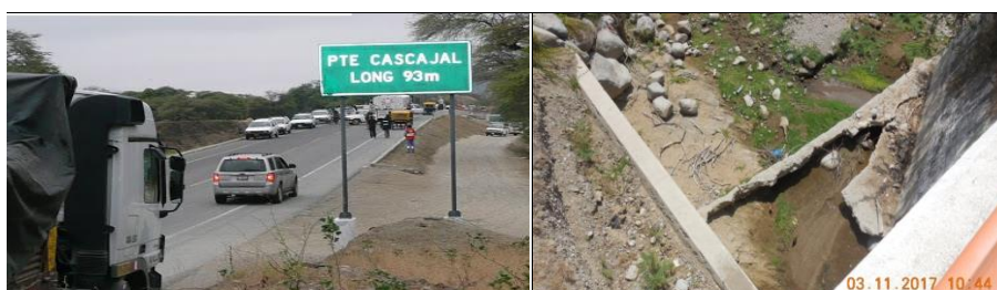
Vista: Estribos del puente Cascajal, deteriorados por acción de la erosión fluvial, propiciada por el Niño Costero del 2017
