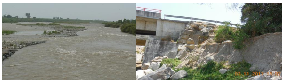
Vista de la margen izquierda del puente sobre el río Cascajal, donde se puede apreciar el desgaste y desplome del muro de protección
