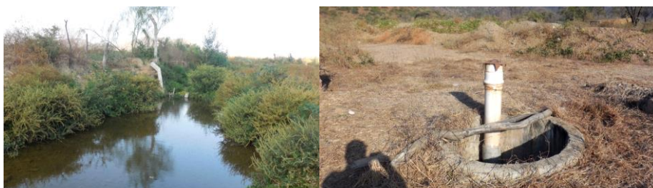
Vista de canal de drenaje colmatado y pozo tubular afectado por el FEN – 2017
